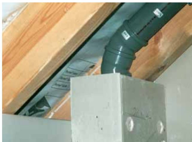
Bild 6 Installationsschacht mündet offen in der Dachschräge
