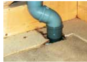
Bild 9: Fallrohbrennlüftung ohne „Stopfen“ auf der Durchdringung des Installationschachtes in den Spitzboden. Die zwangsläufige Folge: Konvektions-Tauwasser
