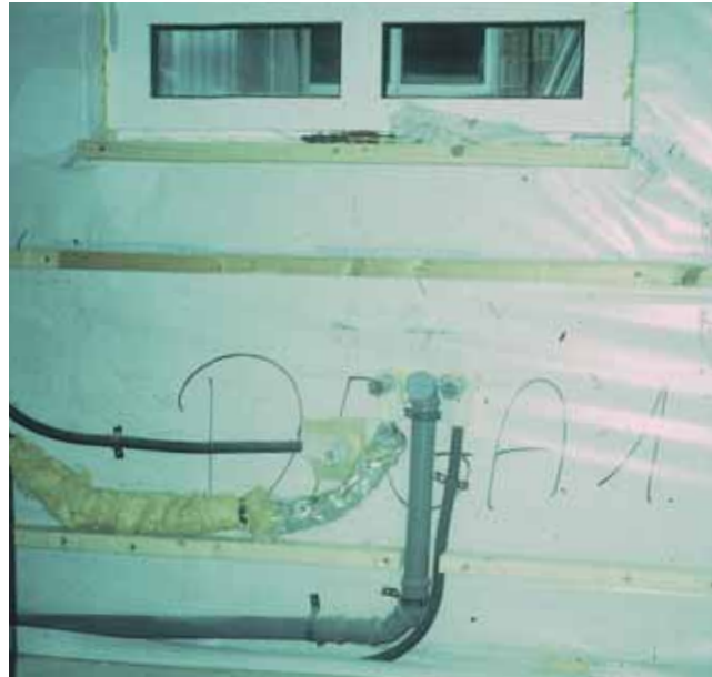
Bild 8: So ist's richtig in Punkto Luftdichtheit: Installation der Anschlüsse für Spüle und Spülmaschine innenseitig der Dampfbremse
