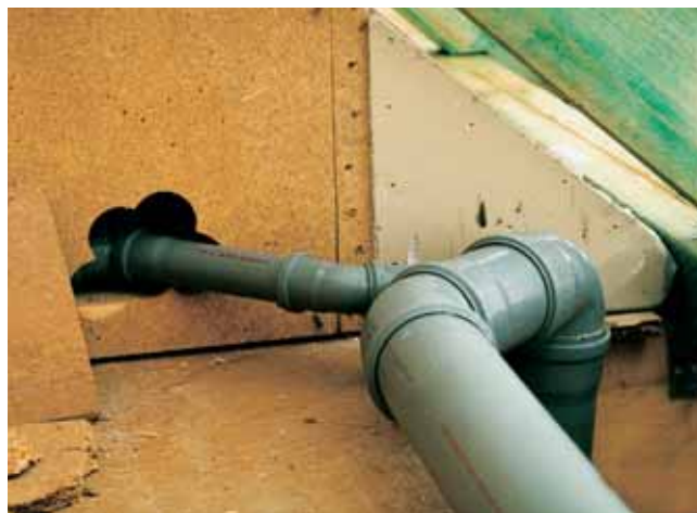
Bild 5: Preisfrage: Wo soll hier noch eine funktionstüchtige Luftdichtung eingebaut werden???
