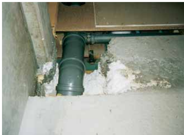
Bild 7: Freier Blick (= freier Weg für Kaltlufteintritt) in Installationswand aus dem Keller
